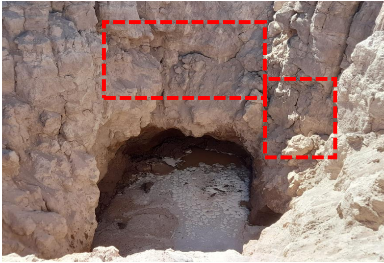
Imagen 6. Presencia de agua y paredes de excavación fracturada o grietas.
