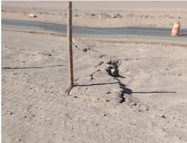
Imagen 4. Asentamiento en sector afectado.
