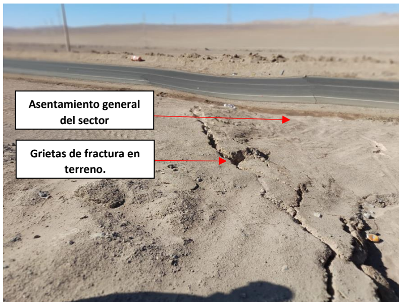
Imagen 3. Asentamiento en sector colindante a calzada.
