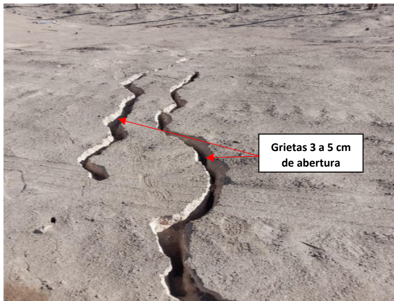
Imagen 5. Grietas en sector colindante a calzada
