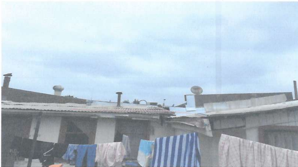
Imagen donde se ve que muros no tienen la misma altura.
