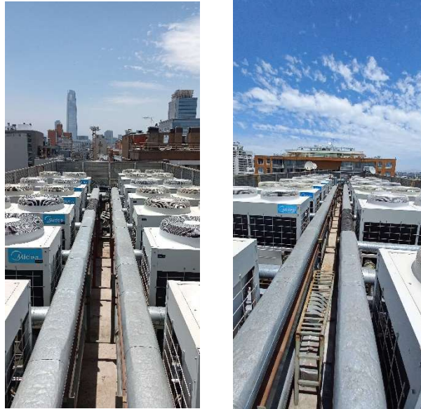
Ubicación Chiller de Climatización
