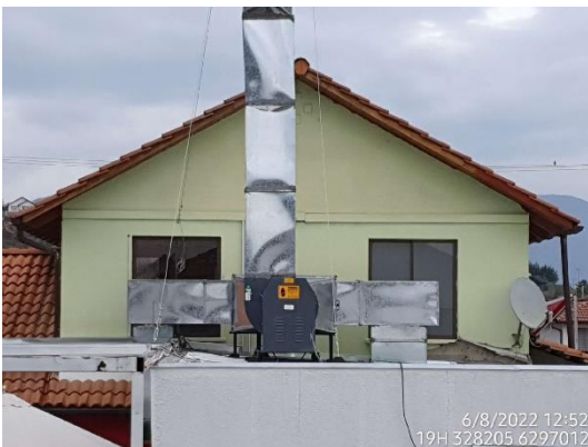
Equipos de extracción en cubierta
