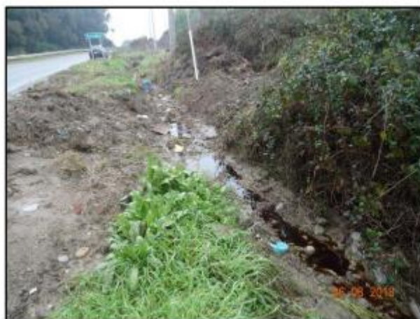
Figura N°9: canal de aguas lluvias paralelo al Vertedero Angol con contacto de residuos y lixiviados.
