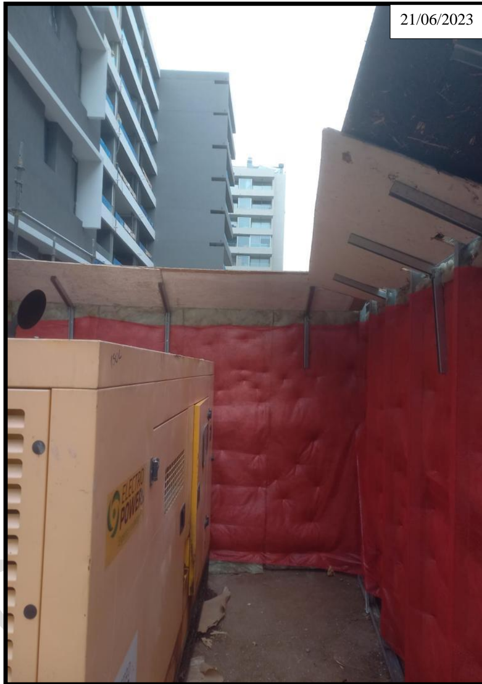
(Grupo Generador N°2)
