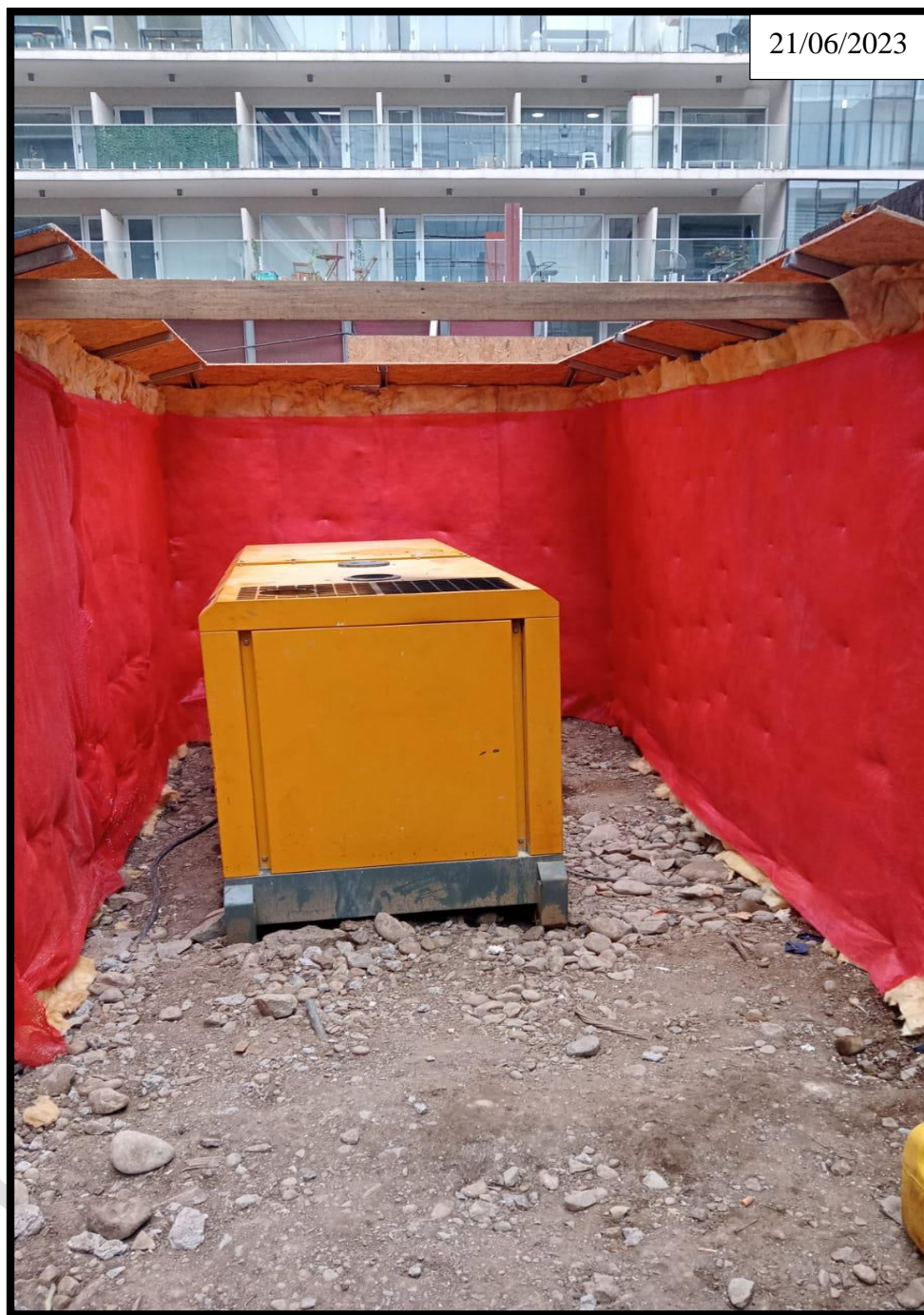
(Grupo Generador N°1)
