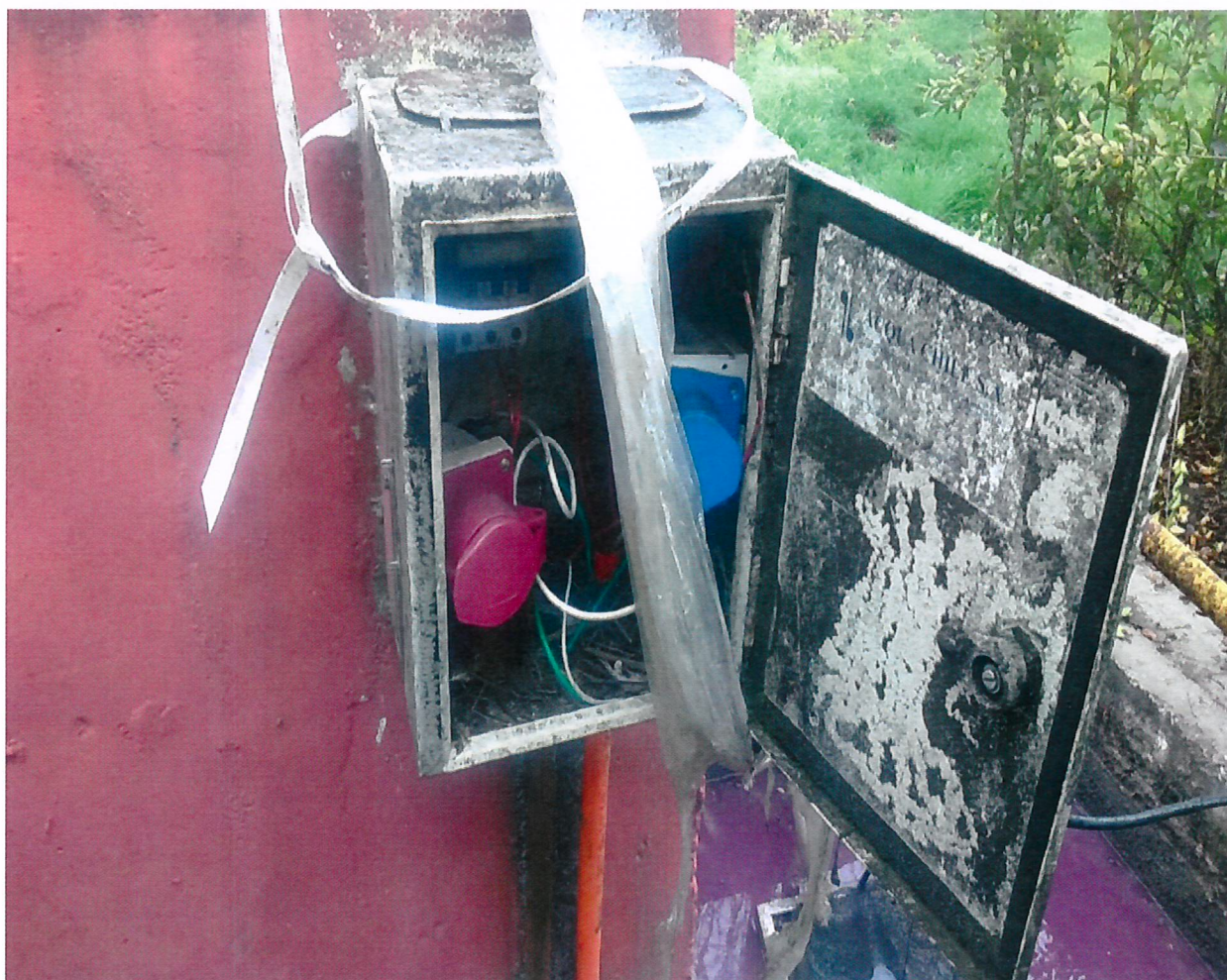
Imagen 17: Caja de protección de circuito sin conexión eléctrica, mal estado de los contactores automáticos y nidos de pájaros en su interior.
