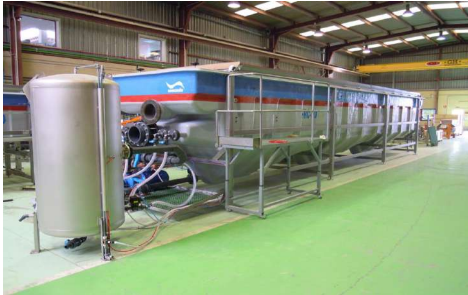
Figura 9-5: Modulo DAF (Flotación por aire disuelto)
