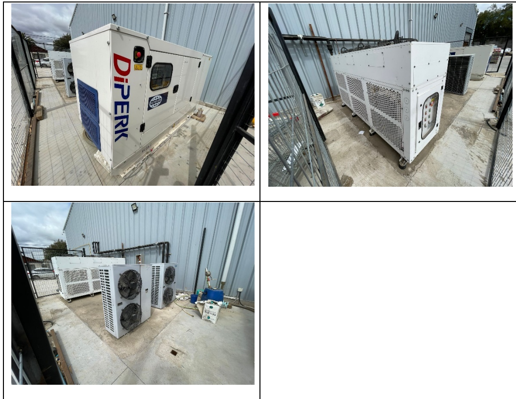
Figura 1 – Registro fotográfico del grupo electrógeno, motor de media temperatura y baja temperatura.
