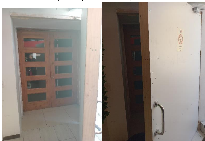
El ingreso al salón tiene doble puerta acústica, por ejemplo la puerta blanca internamente esta construida con material acústico como lana mineral y absorbente acústico tiene un espesor de 10 cm
