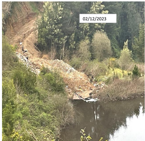
Escorrimento lixiviados desde piscina no autorizada a estero El Mosco
