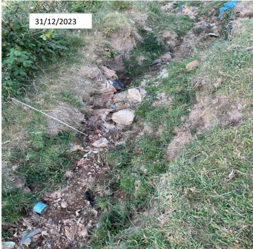
Canalización de aguas lluvias del vertedero sin mantención
