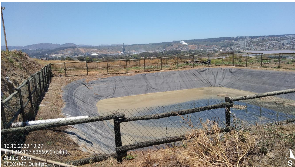
Imagen 9. Estado actual piscina aguas lluvias
