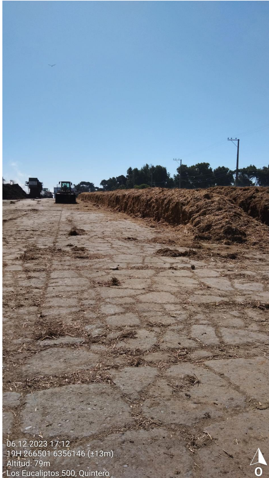
Imagen 5. Losa de sustrato seca a medida que se aleja de piscina purín
