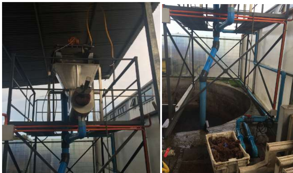
Figura 4. Filtro y estanque de almacenamiento sólidos.
