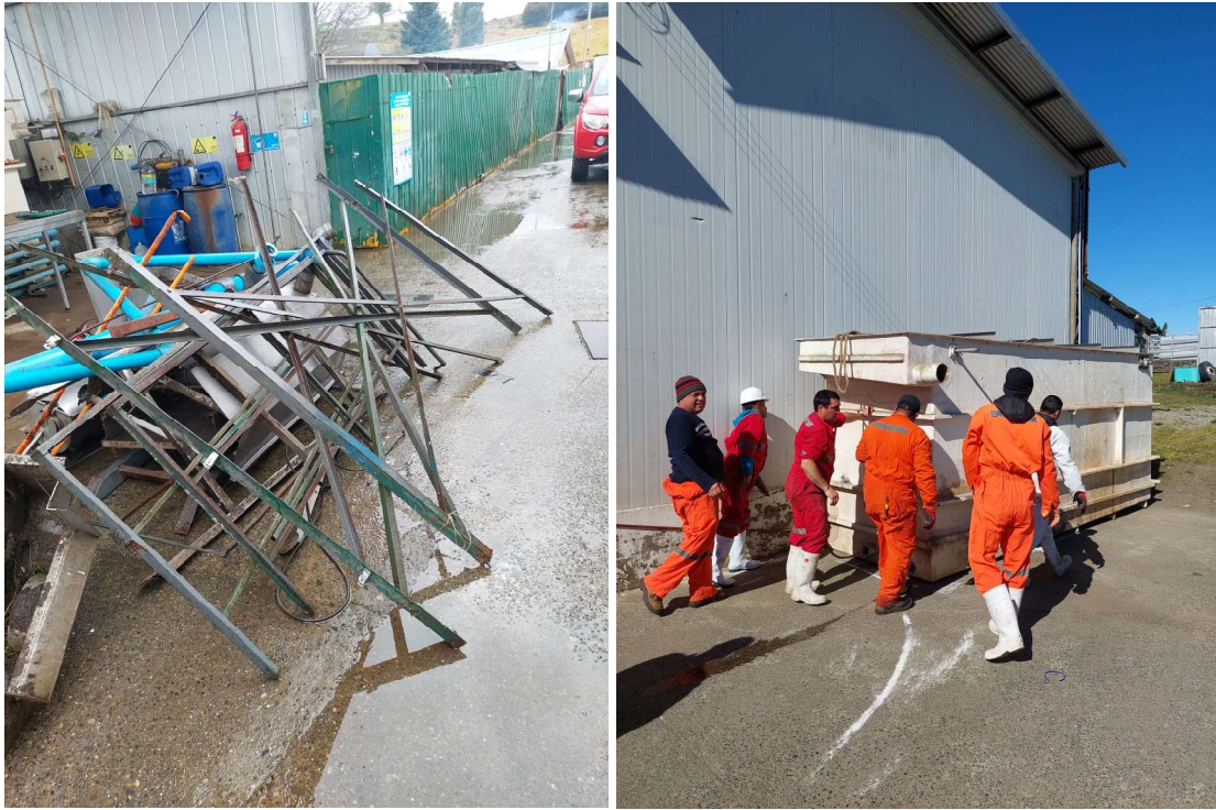
Figura 10. Retiro estanque y de otras estructuras metálicas y plásticas.
