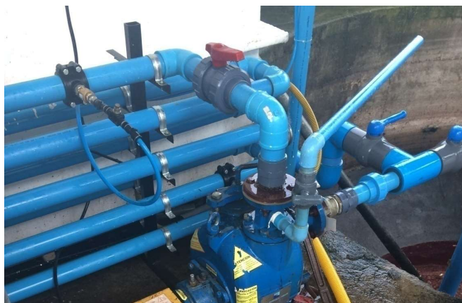
Figura 5. Serpentín y bombas.
