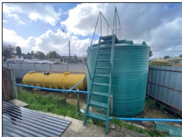
Fotografía N°5: Sistema de acumulación actual de RILes para disposición final
