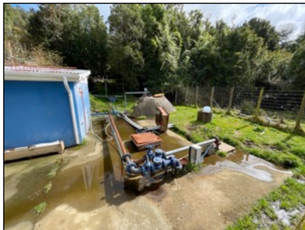
Fotografía N°8: Pozo B, agua subsuperficial, APR PidPid, abastecimiento agua potable rural principal.
