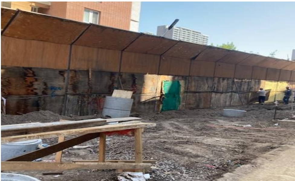
Trabajadores refuerzan tabiquería sellando con doble capa de lana mineral espacio de posible fuga de ruido , Trabajos realizado el 23, 24 y 25 de Marzo del 2023
