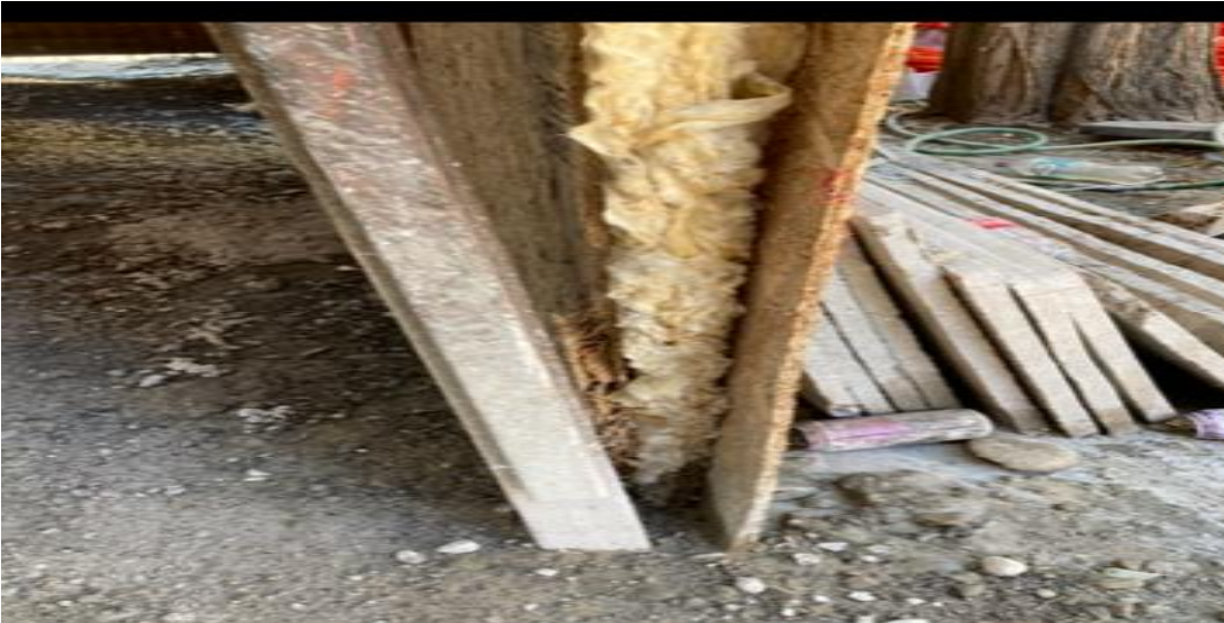
Tabiquería del túnel acústica que se encontraba en mal estado al momento de la Fiscalización y que fueron reparados el 24 de Marzo 2023
