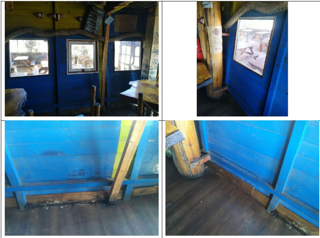
Ilustración 2. Vistas desde el interior de la fachada sur, Cristales nuevos y sello de fugas acústicas.
