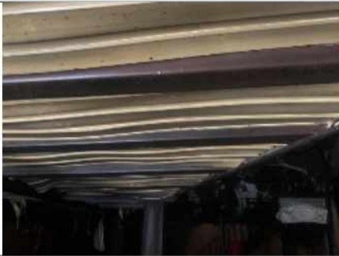
Vista de daños en cielo
