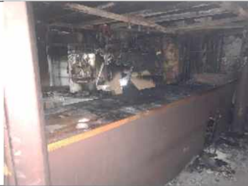
Visa de daños en interior de local sector bar
