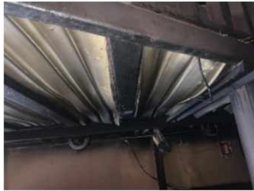
Imagen 6: daños en cielo
