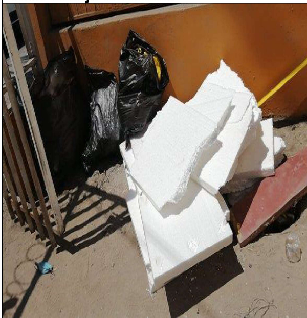
Escombros producto del trabajo
