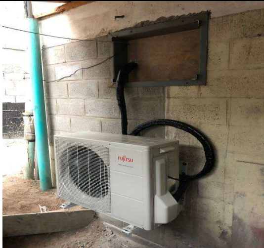
Equipo operando en su etapa de frio
