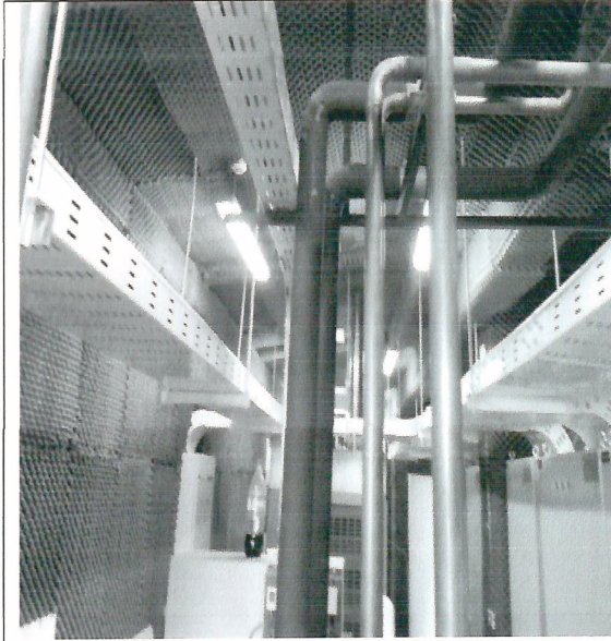
Tratamiento Acústico para Generador de emergencia Supermercado Santa Isabel Quillota CENCOSUD
