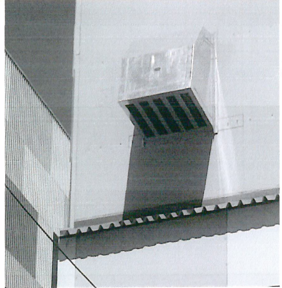
Spliters Fabricados en Planta Termoeléctrica Bocamina Coronel, ENDESA S.A
