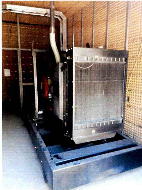
Imagen 6: Sala Grupo Electrónico - Generador Ubicación: 339696 E, 6296438 N
