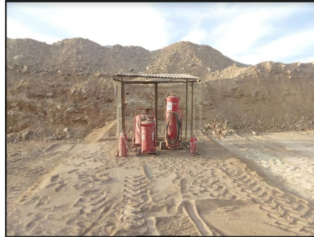
Fotografía 3: equipos de extinción de incendios Depósito N°8 ubicación Datum WGS 84 huso 19 361680E 6959295N, Fotografía 11 de diciembre del 2018.
