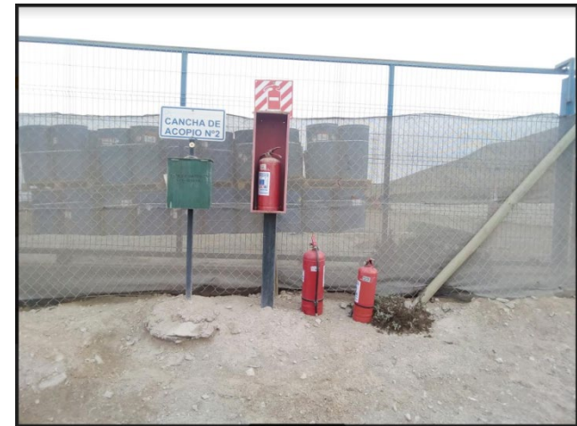
Fotografía 2: equipos de extinción de incendios cancha de acopio N°2 ubicación datum wgs 84 huso 19 361631E 6959180N, Fotografía 11 de diciembre del 2018.
