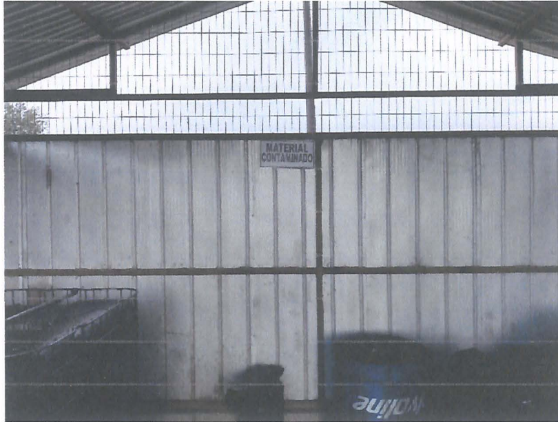
Rotulación receptáculos Material Contaminado
