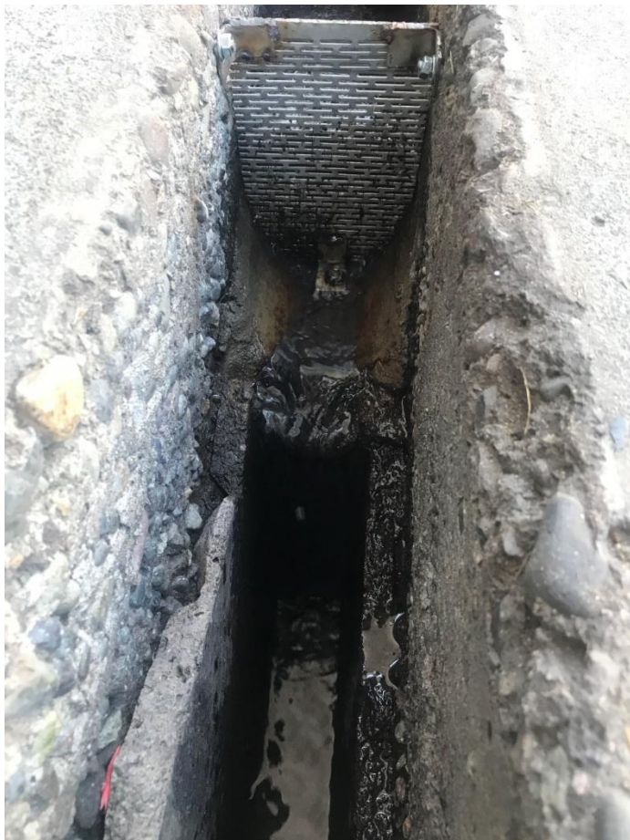
Rejillas instaladas en bodega de vinos Viña Apaltagua
