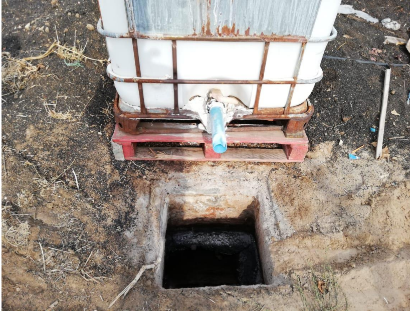
ANTES Zona de dosificación de soda cáustica
