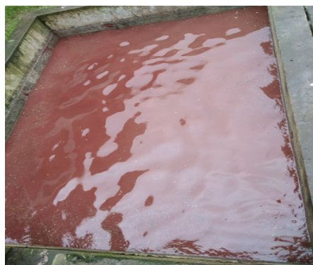
Foto N°2: Estanque de homogenización en operación
