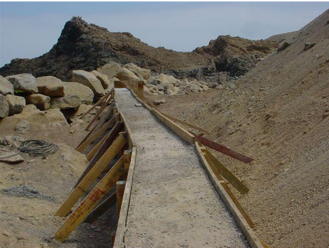
Registro gráfico de la construcción del nuevo muro de contención, construido sobre el antiguo (2005)
