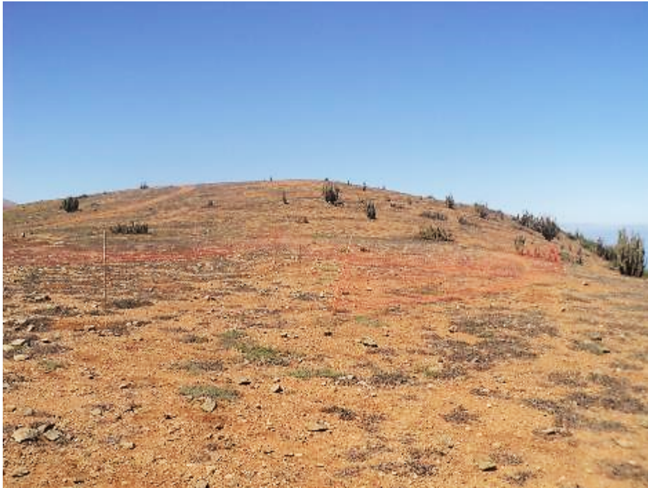
Fotografía 43: Delimitación de áreas de trabajo en base torre T7, octubre 2016 (UTM E: 353868, UTM N: 7234069). Datum WGS 84, UTM 19 Sur.
