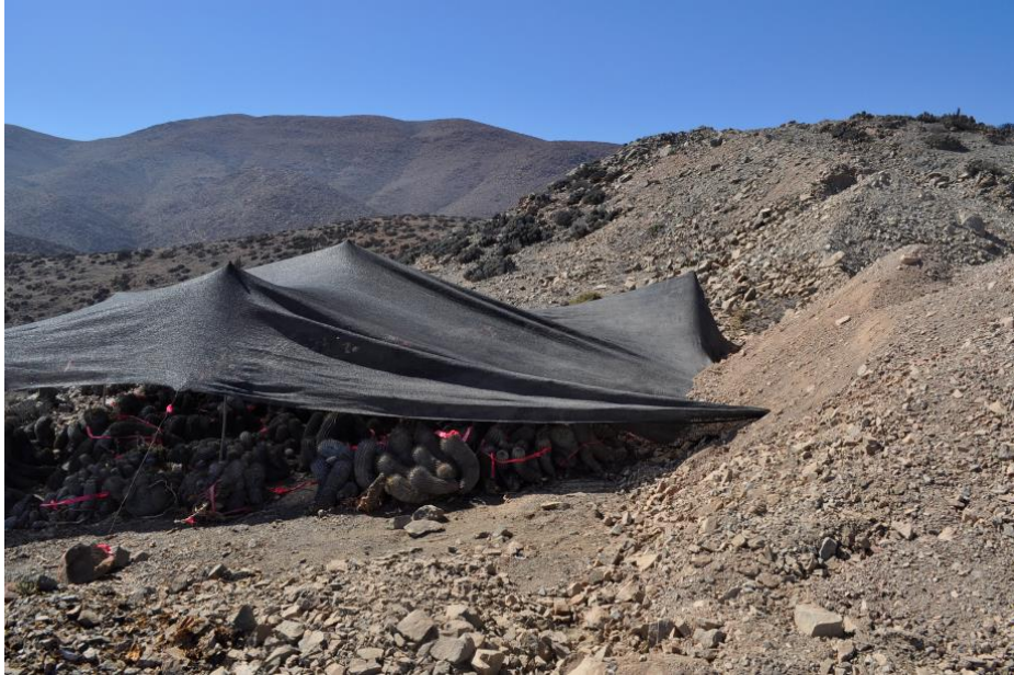
Fotografía 16: Estado del sombreadero T11 una vez reparado, utilizando el acopio para tensar la malla raschel.
