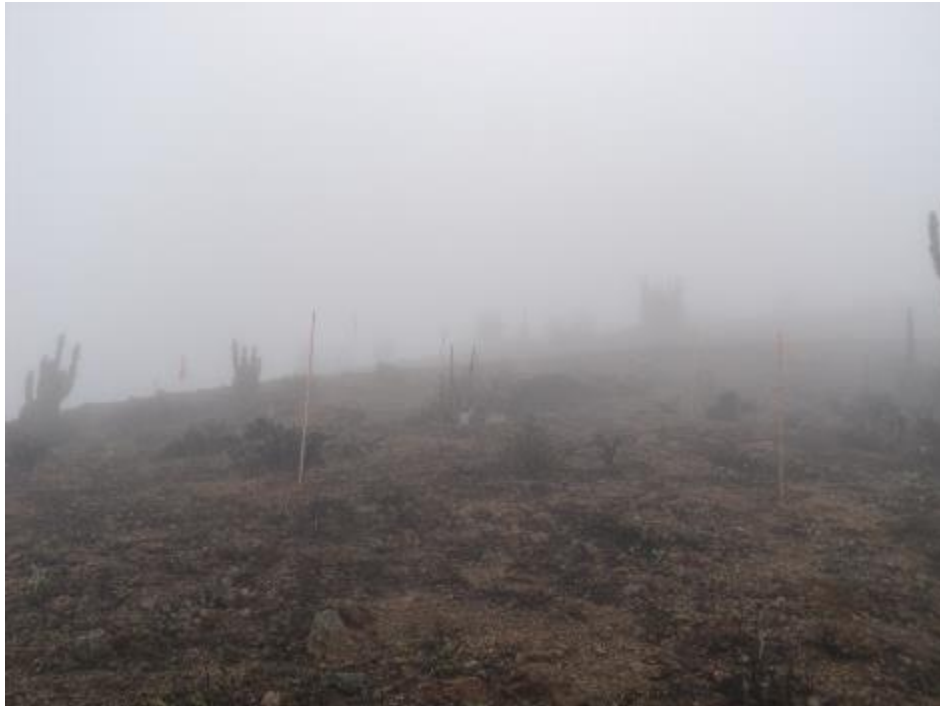
Fotografía 37: Delimitación de áreas de trabajo en camino de acceso a torre, T10, octubre 2016 (UTM E: 354797, UTM N: 7234098). Datum WGS 84, UTM 19 Sur.
