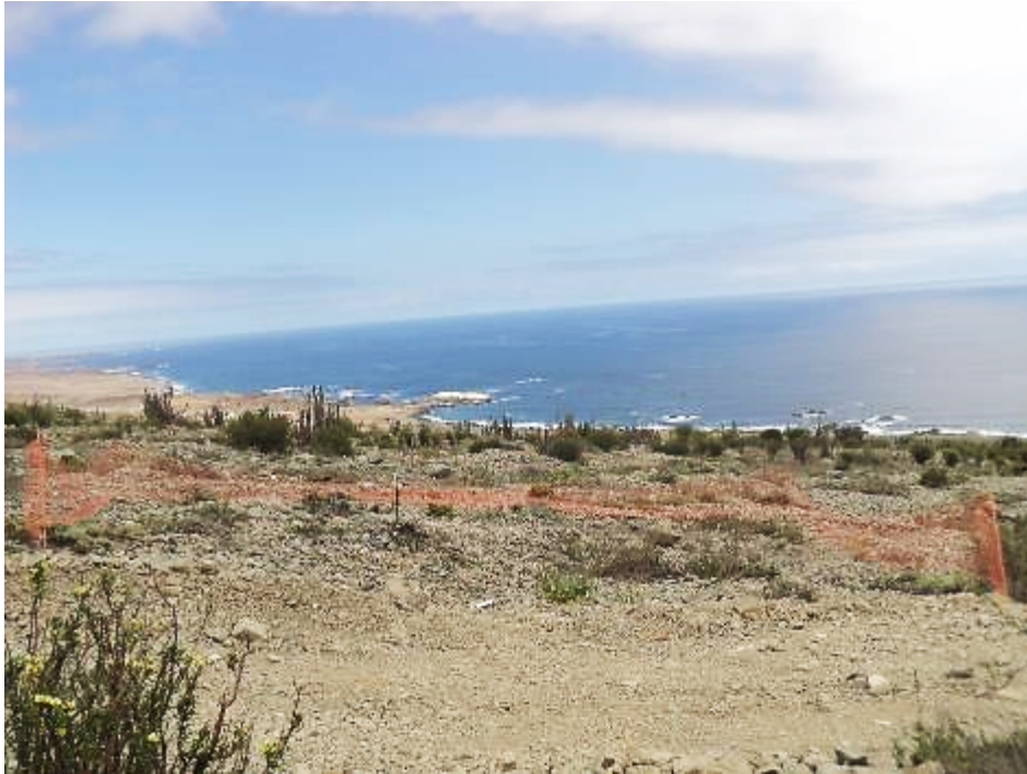
Fotografía 46: Delimitación de áreas de trabajo en base torre, T4, octubre 2016 (UTM E: 353097, UTM N: 7234747). Datum WGS 84, UTM 19 Sur.
