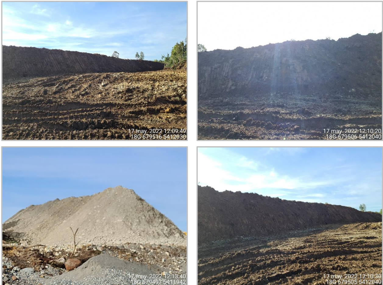
Figura 3: Barrera Acústica compuesta por acopio de material en frente activo de trabajo.
