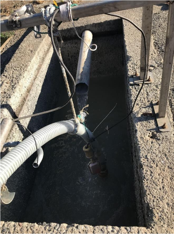
Piscina de recepción del Ril tratado previo a la aireación
