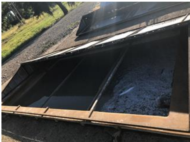
segunda piscina de decantacion conformada por tres compartimientos
