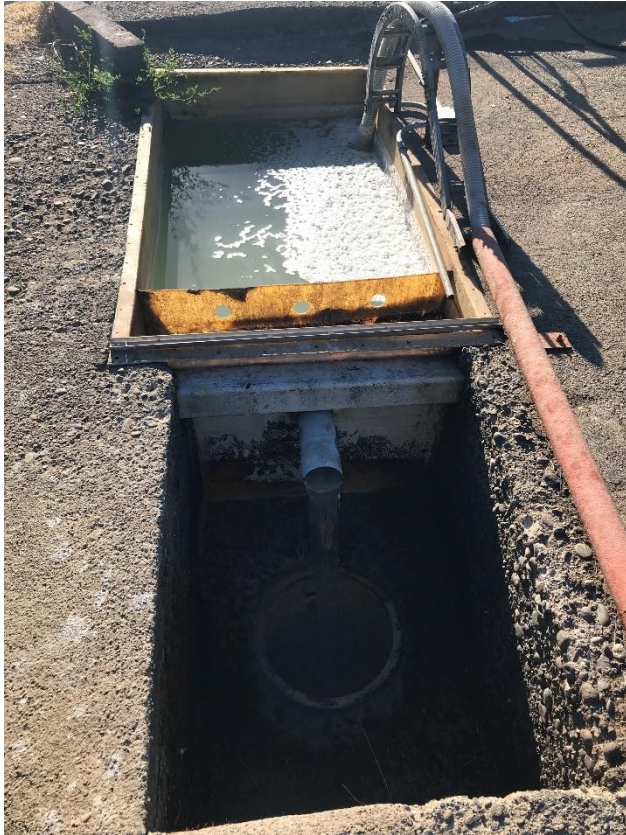
Cámara de descarga Ril
