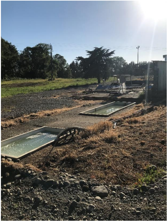
Posterior a la aireación pasa a las piscinas en donde retorna a la cámara de descarga
