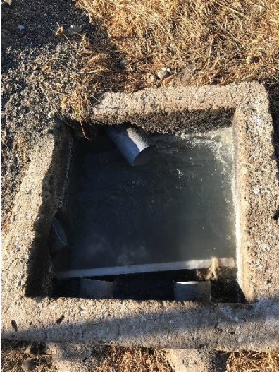
Cámara de ingreso de riles
