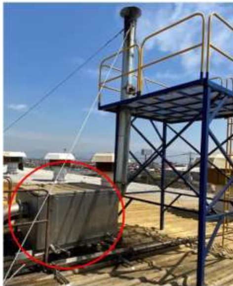
Ilustración 4 Filtro Chimenea Salida Freidora
