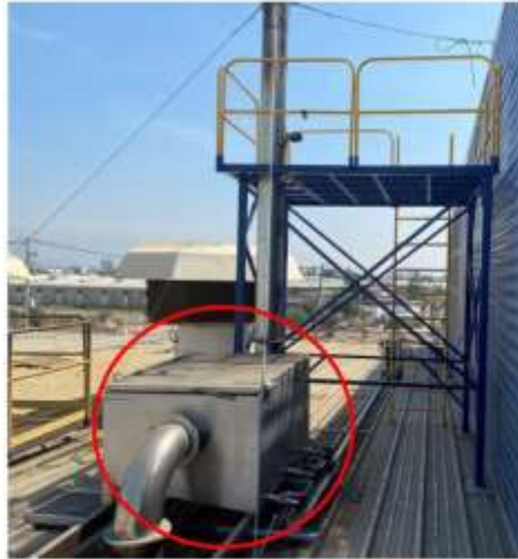
Ilustración 3 Filtro Chimenea Entrada Freidora
