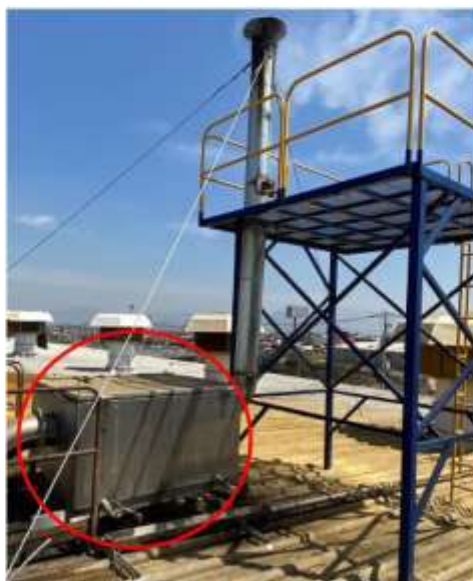
Ilustración 4 Filtro Chimenea Salida Freidora
