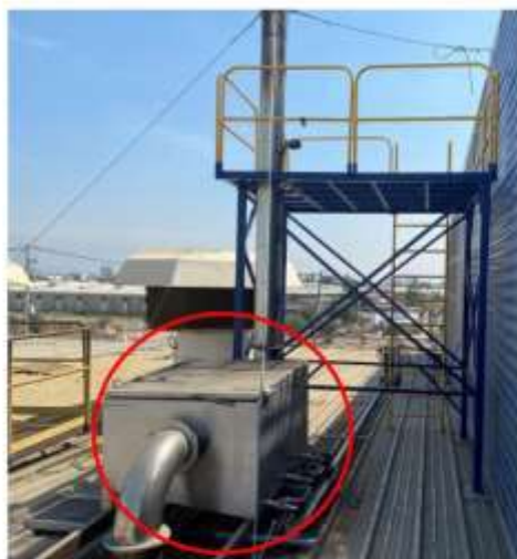
Ilustración 3 Filtro Chimenea Entrada Freidora
