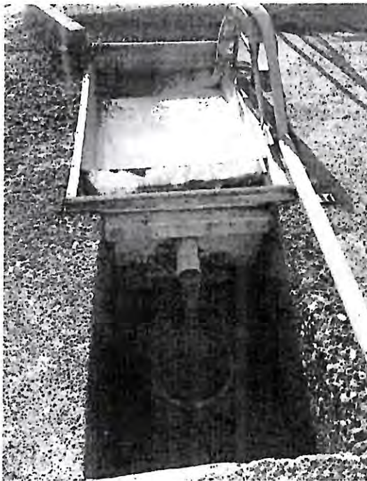
Cámara de descarga Ril
