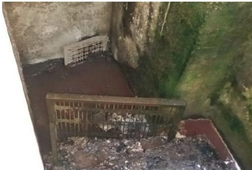
Referencia: Fotografía N° 6 del IFA DFZ-2020-2802-XI-NE.
