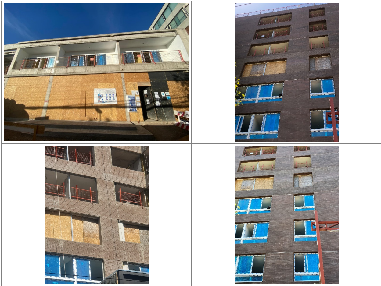
FIGURA 5. IMAGEN DE CIERRE DE VANOS CON PANELES DE OSB EN FAENA MANUEL MONTT 1204
