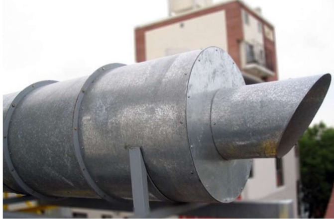
Figura 17: Silenciador en grupo electrógeno
