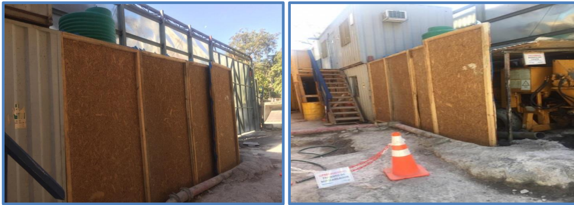
Figura 8. Apantallamiento Parcial Bomba de Hormigón.
