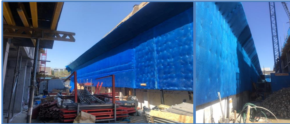
Figura 7. Ejemplo de Barrera Perimetral de Cierre de Obra.
