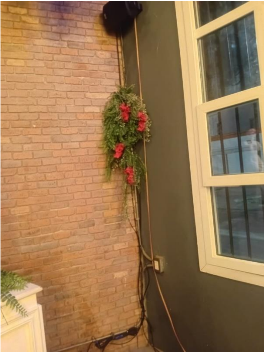
Cableado a la vista
