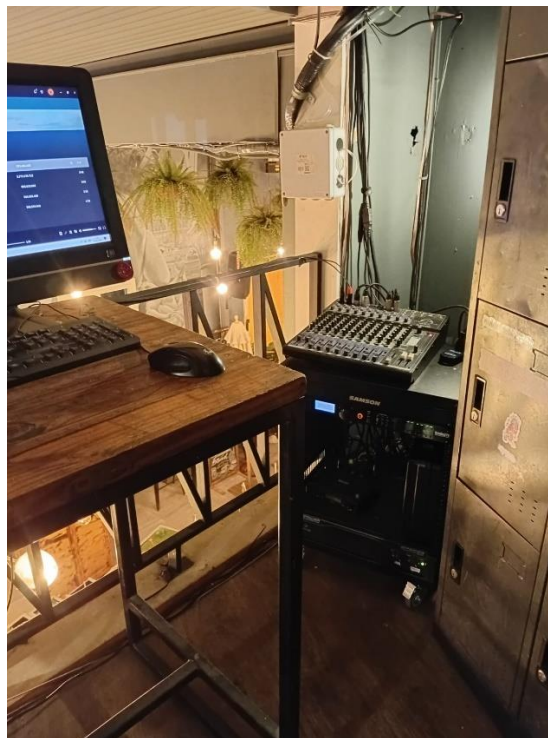
Zona de Rack y PC organizada
