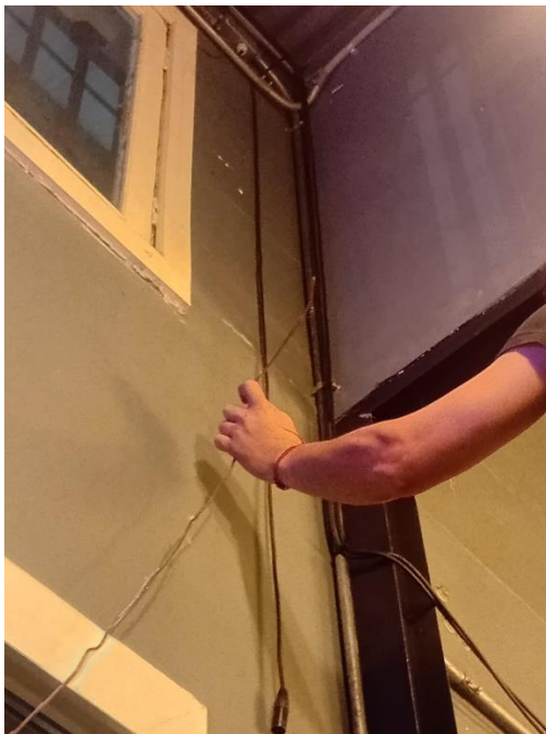
Cableado a la vista
