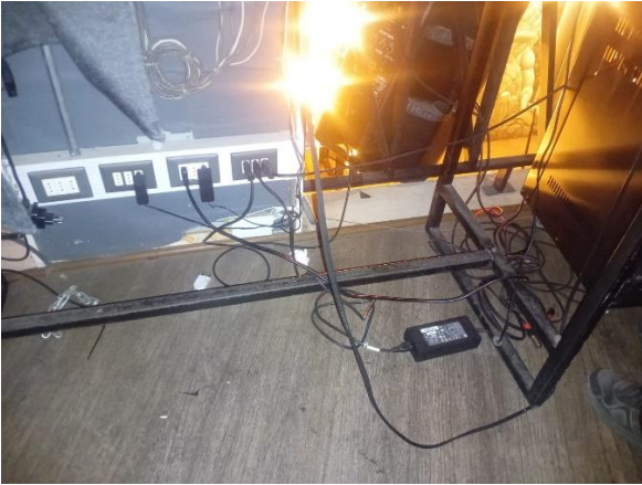
Zona de Rack y PC desorganizado
