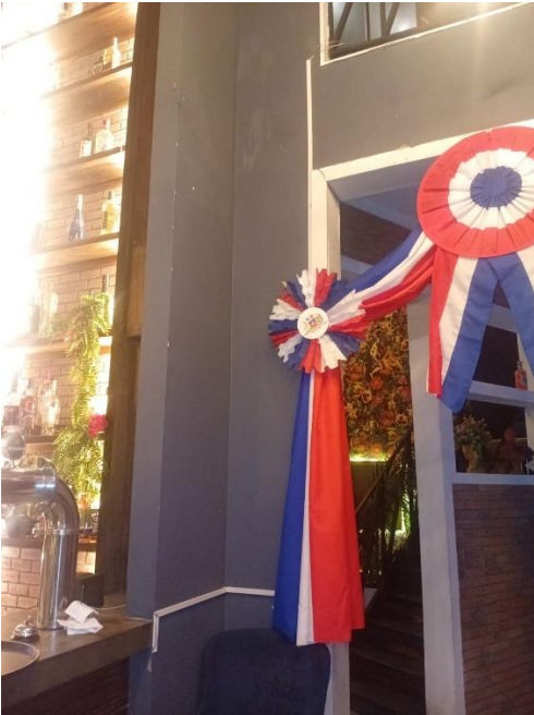
Canalización cortando el plano de la pared
