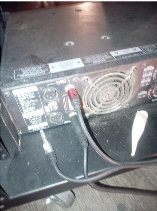
Cable Mixer-Amplificador en mal estado
