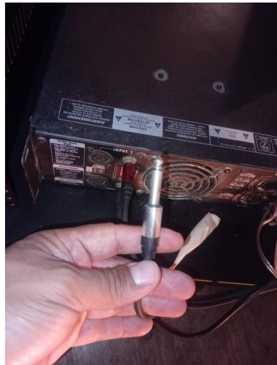
Cable Mixer-Amplificador en mal estado
