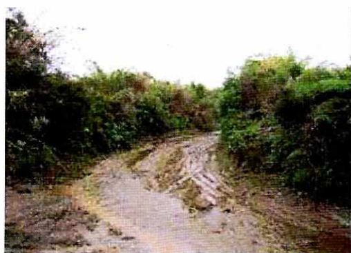
Figura N°2. Huella (drenaje existente). Vista 1
