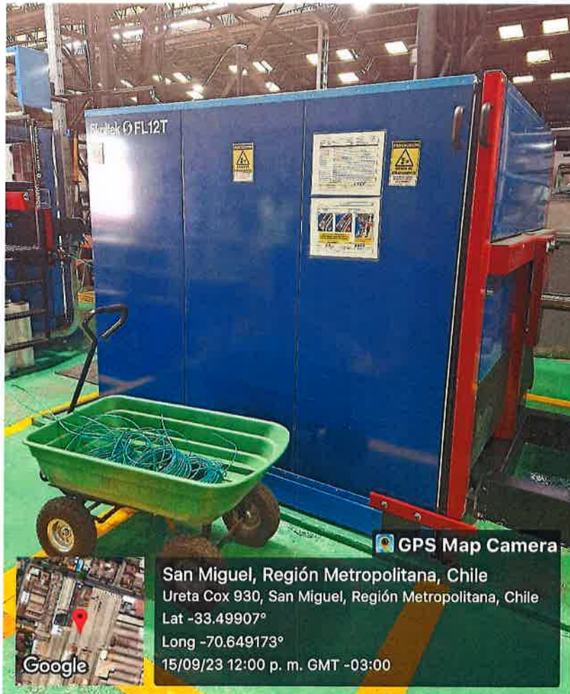
Ilustración 17. Cabina de protección acústica máquina 409
