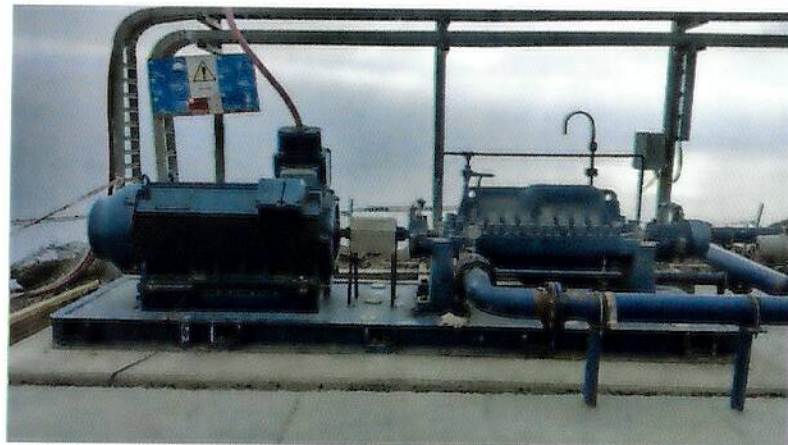
Figura N°7: Estación de Impulsión EB1.
