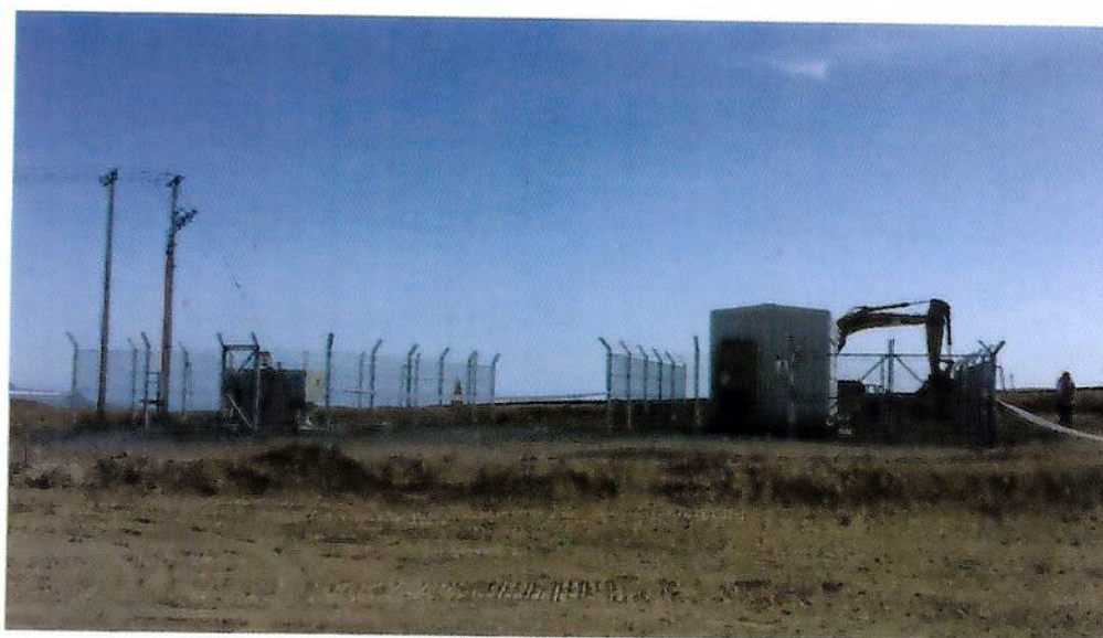
Figura N°10: Estación y Sala Eléctrica Principal.
