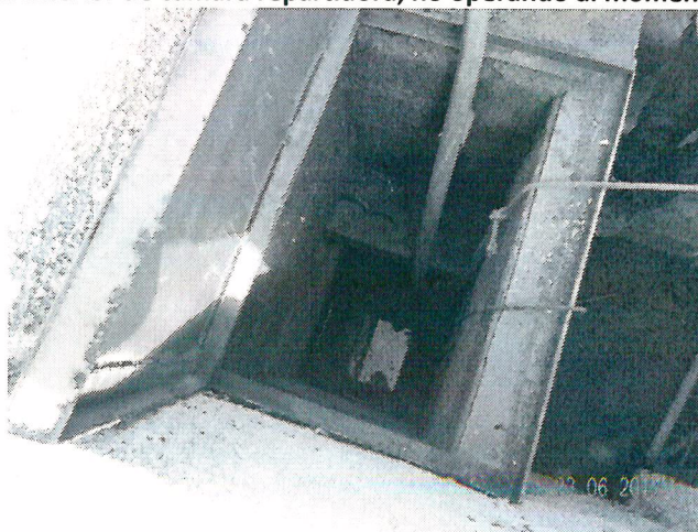
Fotografía 2: Vista interior de cámara repartidora, no operando al momento de la inspección
