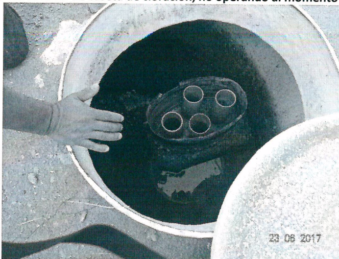
Fotografía 1: Vista interior de caseta de cloración, no operando al momento de la inspección
