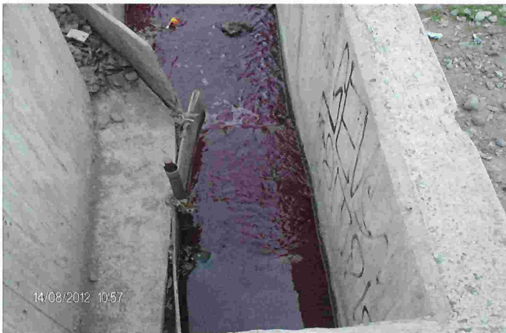
Imagen N° 1. Riles sin tratar, saliendo de la planta, Olivar Bajo Ruta H 40. 1
