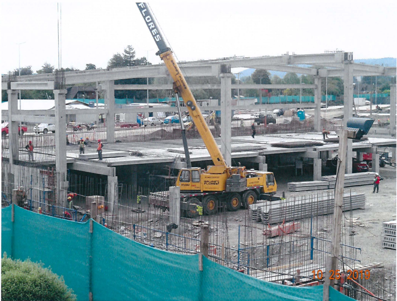
Imagen 3. Fotografía actualizada al 25.10.2019 donde se observa "Construcción Sodimac Los Pablos", de la ciudad de Temuco. (fotografía tomada del tercer piso de una vivienda que presenta las molestias de ruido).
