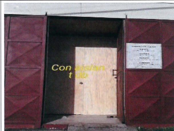
Imagen N°10: Puertas después de la instalación de aislante. Imagen proporcionada por el titular.
