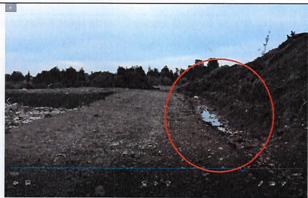
Fotografía N°6: en imagen se resalta canalización de aguas lluvias de conformación deficiente en el sector Oeste del sitio de disposición de residuos.
