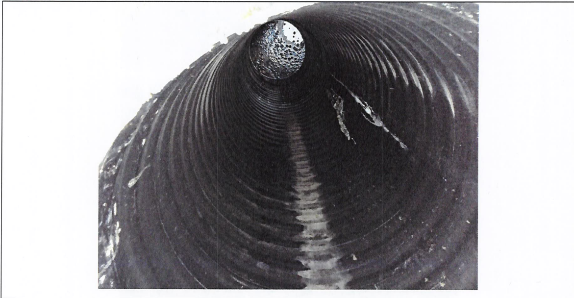
Fotografía N°4: Imagen constata chimenea pasiva con aguas lluvias y burbujeo.
