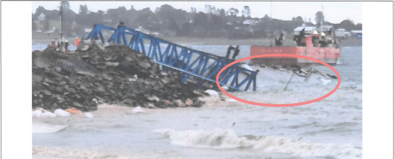
Imagen N°1: Evidencia del colapso de la estructura, la cual contemplaba puente de acceso basculante de estructura metálica además de un muelle flotante. En círculo rojo, se observa parte del muelle hundido.
