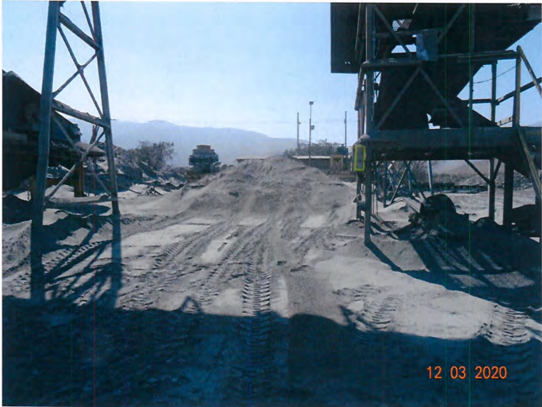
Foto 1.a: Pila y acumulaciones de polvo mineral en el área del Chancador 3°, marzo de 2020.
