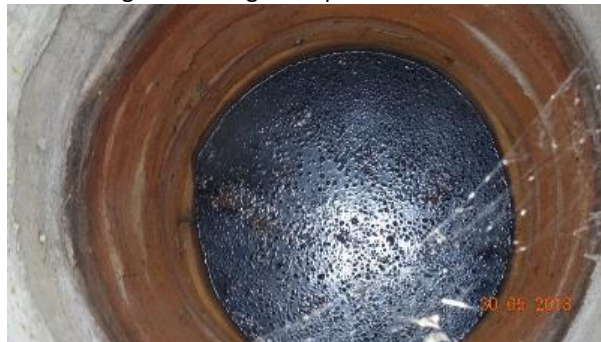
Imagen N° 3 “Agua de pozo contaminada”
