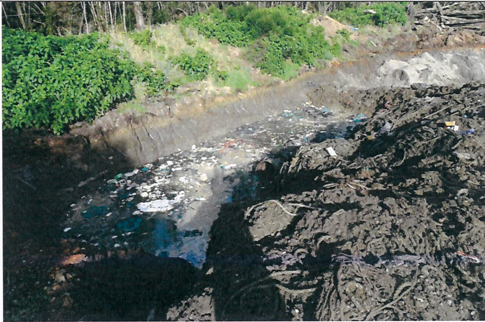
Fotografía N°8: Se constata existencia de pozo de acumulación de líquido de tonalidad verdosa, mezclado con residuos sólidos de tipo domiciliario, y tarro de pintura. Se observan redes enterradas alrededor.
