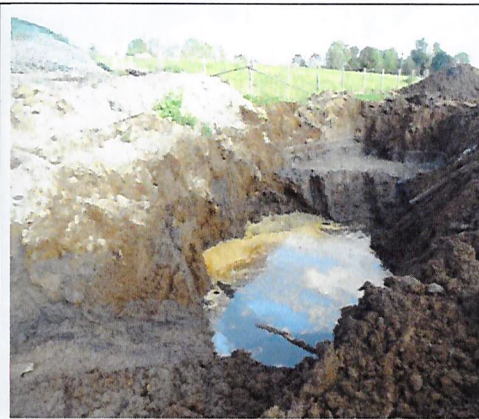
Fotografía N°13: Se observa dos pozos sin impermeabilizar, para la acumulación de líquidos provenientes de la zona de recepción y armado de redes.
