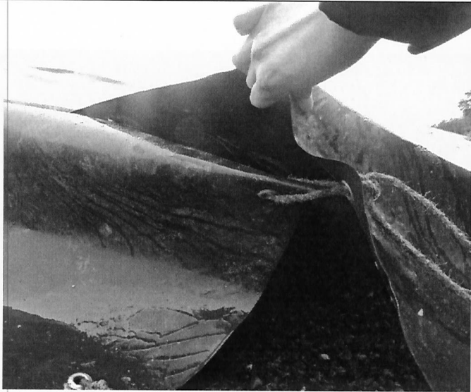
Fotografía N°8: Se observa costuras de geomembrana sin sellar, permitiendo el ingreso de aguas lluvias.
