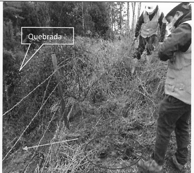
Fotografía N°9: Zona que da hacia quebrada, con vegetación muerta y en mal estado. Se observa zona barrosa negra (rojo) y sector de escurrimiento de lixiviados (flecha roja).
