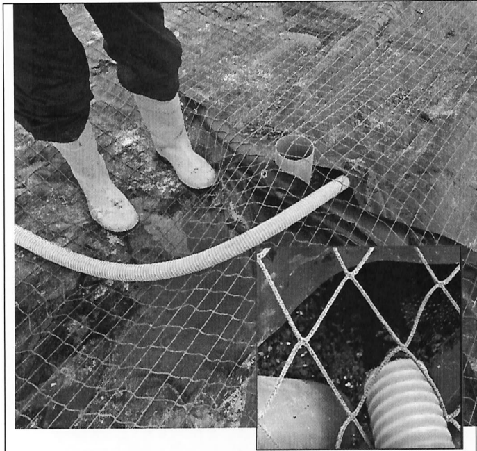
Fotografía N°19: Se observa manguera amarilla proveniente del sistema de lixiviados. Se constata que se vierte directamente sobre la pila (sin sistema de drenes superficiales de riego) líquido lixiviado negro.
