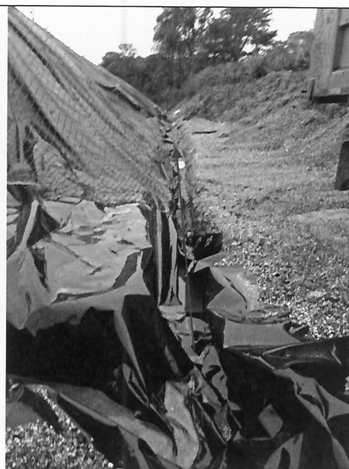
Fotografía N°2: Se observa canalización de aguas lluvias de pila Sur, en mal estado, y con sector sin impermeabilizar.
