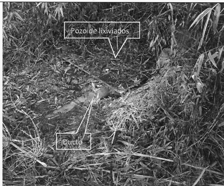
Fotografía N°18: Se constata existencia de pozo de lixiviados oculto bajo la vegetación, y cubierta con plancha OSB. Se observa ducto proveniente de las pilas de acopio.
