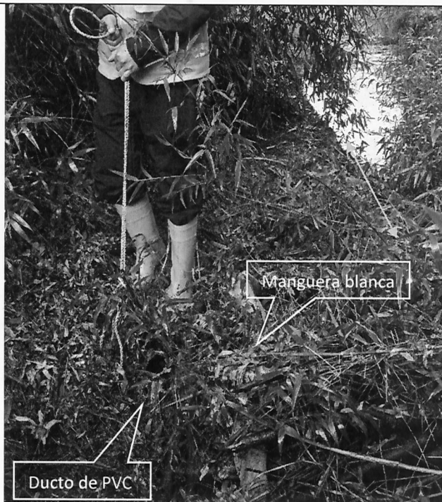
Fotografía N°16: Se observa extremo Norte de canalización de fotografía N°15 (flecha amarilla). Se constata existencia de ducto de PVC y manguera blanca oculta bajo la vegetación.
