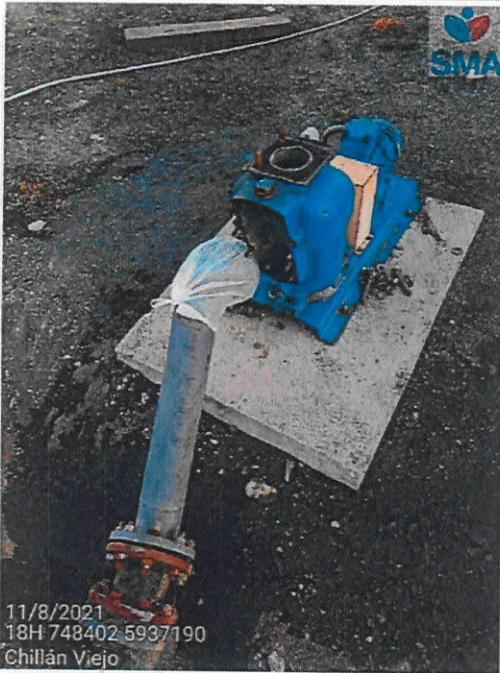
Foto N° 7. Estación N° 5 bomba de recirculación de biodigestores en mantención donde se habilita bolsa plástica para control de olores.
