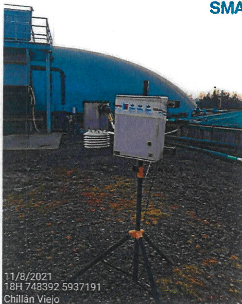
Foto N° 9. Estación N° 5 habilitación de estación de monitoreo de gases biodigestores.
