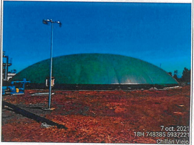
Foto N° 9. Estación N° 7 zona de biodigestores.
