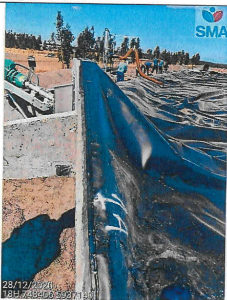
Foto N° 3 Primer plano agitador sector poniente del Digestor Primario N° 2 termosellado. Atrás, trabajos de terminación lámina superior mismo digestor.
