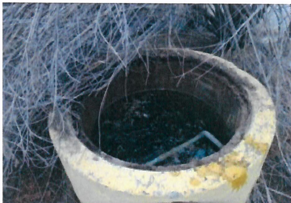
Fotografía Cámara de inspección piscina de emergencia (Fuente denuncia ID 15697)
