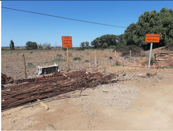
Fotografía 15. (Fuente: Inspección ambiental SMA 14-12-2021)
