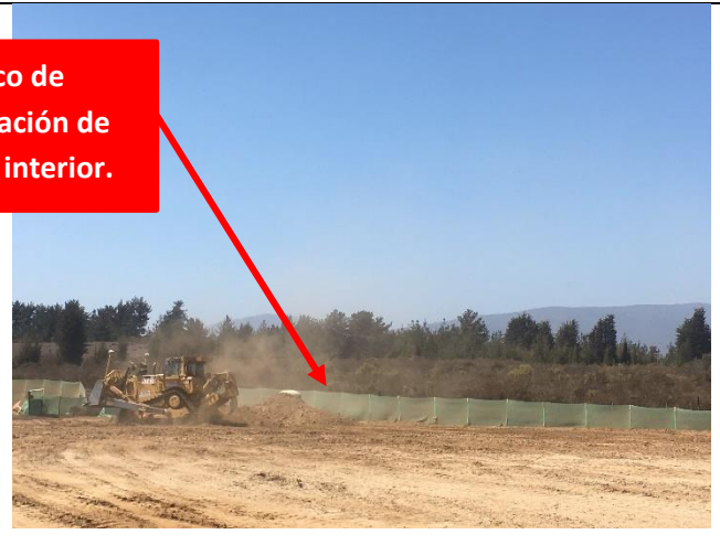
Fotografía 26. (Fuente: Inspección ambiental SMA 01-03-2022) Descripción: Trabajos de avance de obras en que se observa maquinaria pesada y generación de material particulado sin cerco para evitar su impacto en la vegetación colindante.
