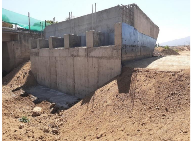
Fotografía 13. (Fuente: Inspección ambiental SMA 14-12-2021)
