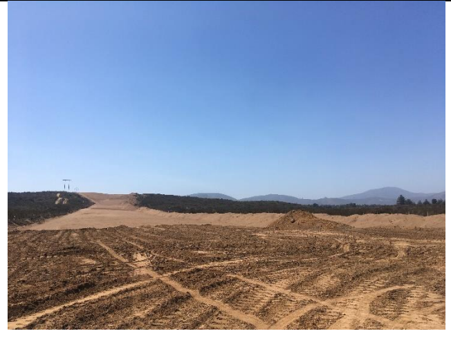
Fotografía 24. (Fuente: Inspección ambiental SMA 01-03-2022) Descripción: Vista hacia el norte en que se observa el material removido y vegetación colindante.
